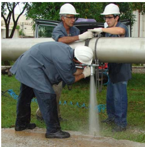
Figura 8 – Dano na parte inferior da tubulação sendo reparado
