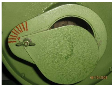
Figura 4. Dumper de controle da vazão do ar de secagem.
