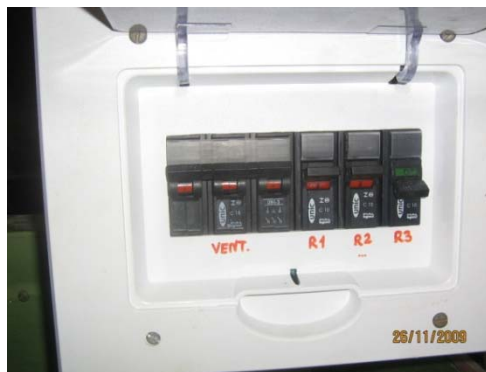
Figura 3. Quadro elétrico de comando.
