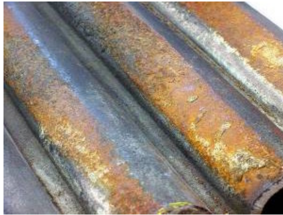
Figura 1. Região afetada por erosão e corrosão.
